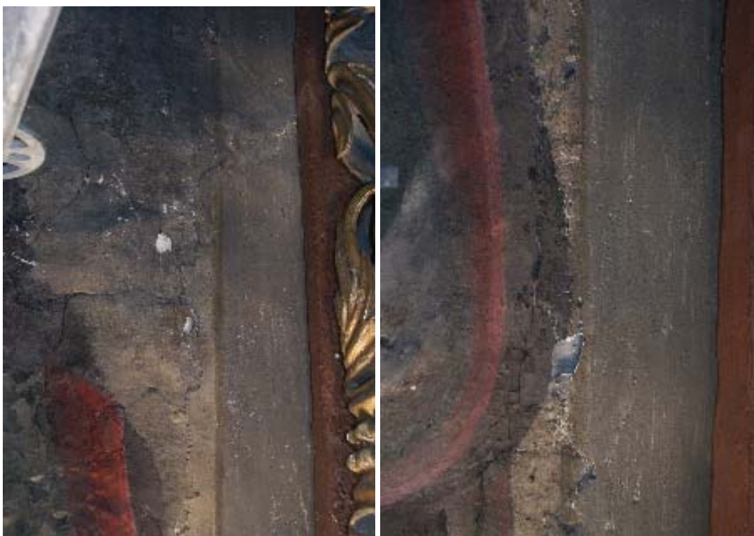
Detalle. Desprendimientos de mortero.
