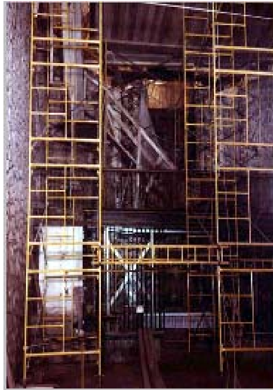
Año 1973. Durante el desmontaje. Es posible apreciar que la disposición del banco y primer Cuerpo no corresponde a la actual.
