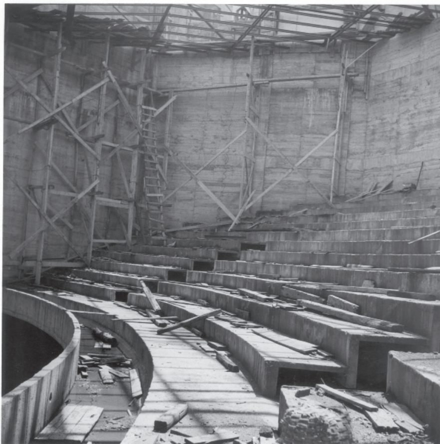
69. irudia. Kolisoeo zinema-aretoaren eraikuntza-lanak, barrualdea. Eibarko Udal Artxiboa. Hirigintza eta Obrak Argazki Funtza. Sig. 13.038. HIF.
