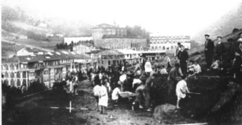
Construcción de la carretera que uniría Eibar con Aguinaga. La total restauración de la carretera de Arrate se llevó a cabo en 1956.
