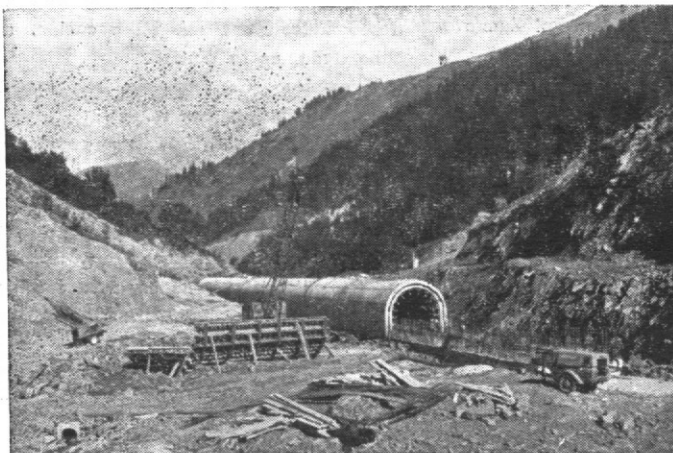
En la foto, la galería de 150 metros. Encima, de orilla a orilla, entre laderas, irá la montaña de piedra.
